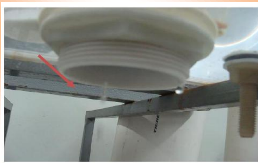
Foto 3 - Gotejamento ocorrido pelo furo na peça.
